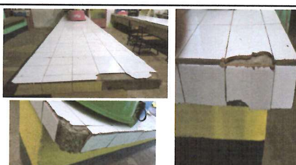
Foto 4: PISO AZULEJO EN MAL ESTADO
